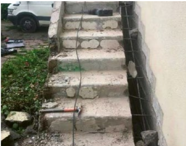
Désolidarisation de l'escalier portant avec suppression du ferrailage avant la mise en œuvre d'une ITE. Les aciers affleurants sont traités contre la corrosion. ©AQC
