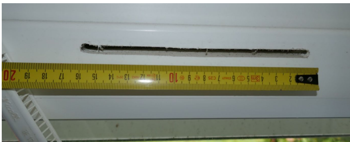
L'entreprise ayant installé les nouvelles fenêtres n'a pas réalisé les mortaises en usine
