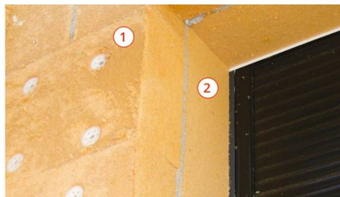
L'ITE des parties courantes ① est complétée par l'isolation des tableaux avec une épaisseur de 40 mm d'isolant ②. Cette solution a été possible, car les menuiseries existantes bénéficiaient de dormants suffisamment épais. ©AQC
